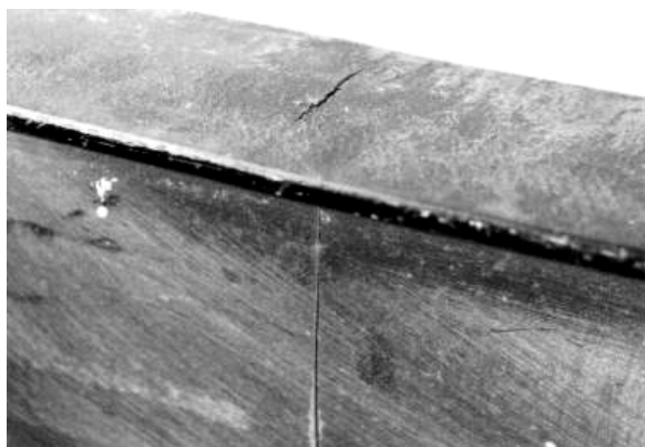
Obr. 17. Protiľahlá strana, prasklina vychádza na povrch pozdĺžnika, zmenšené 4,1x
